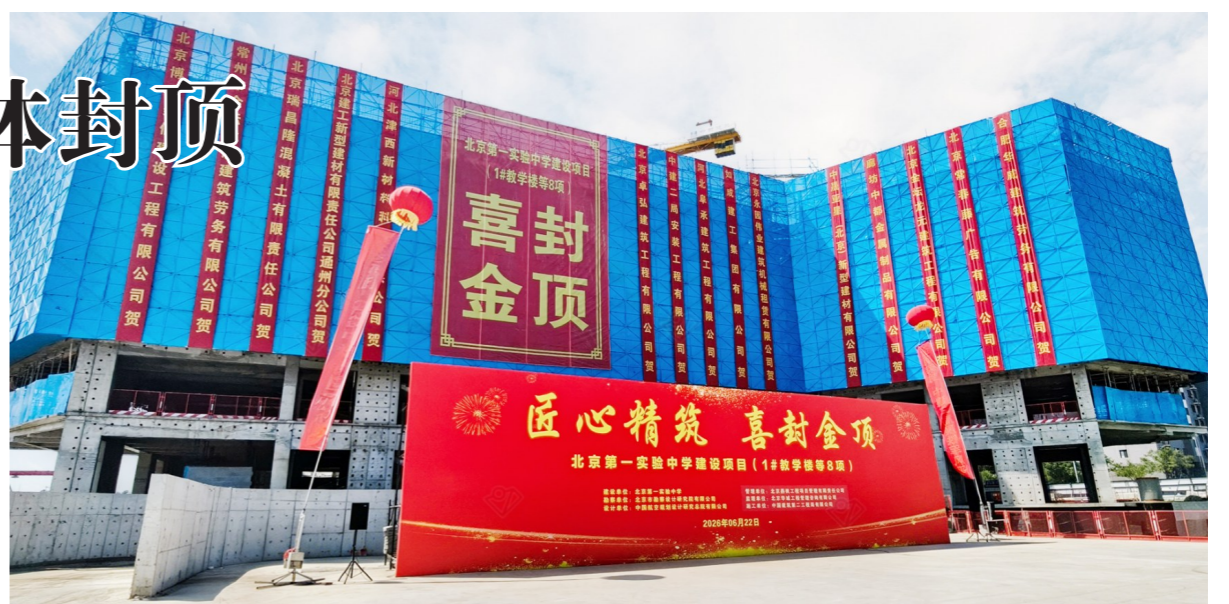
北京第一实验中学通州校区主体结构封顶,落成后将释放2970个学位。记者 常鸣/摄
