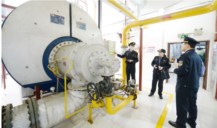
工作人员对供暖设备进行监督检查。
