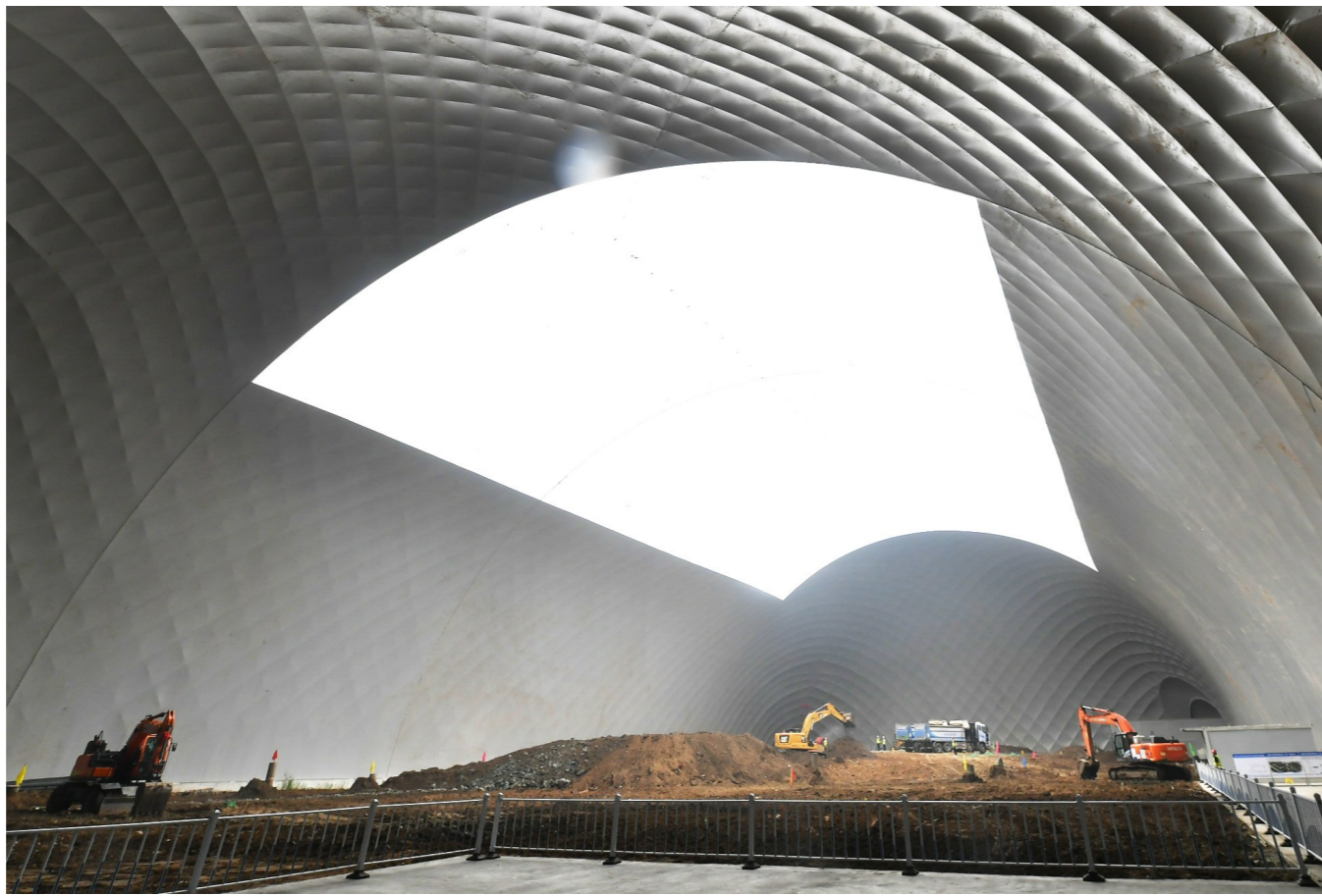
基坑气膜可源头解决扬尘、噪音等一系列问题,打造通州区绿色施工“样板”。记者 常鸣/摄
