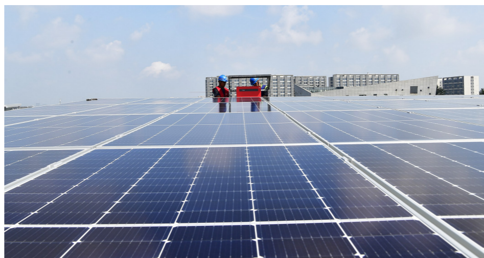
十一学校通州实验学校,光伏已安装完成。记者 唐建/摄
