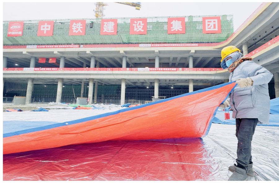
工人为站房核心区站台层混凝土覆盖保温被。记者 金耀飞/摄
