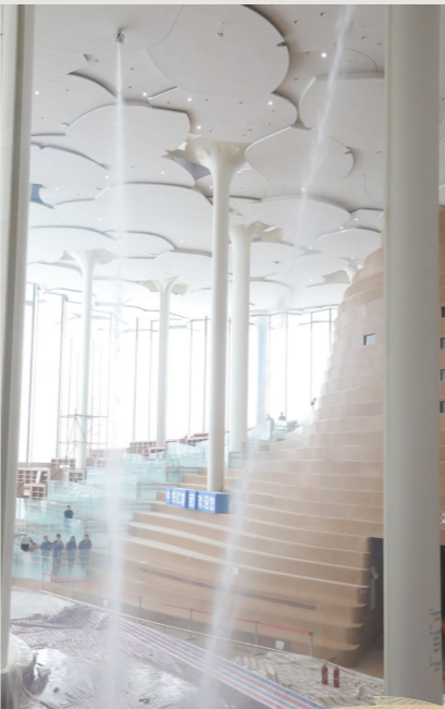
北京城市图书馆“银杏叶”屋顶喷头精准灭火。
