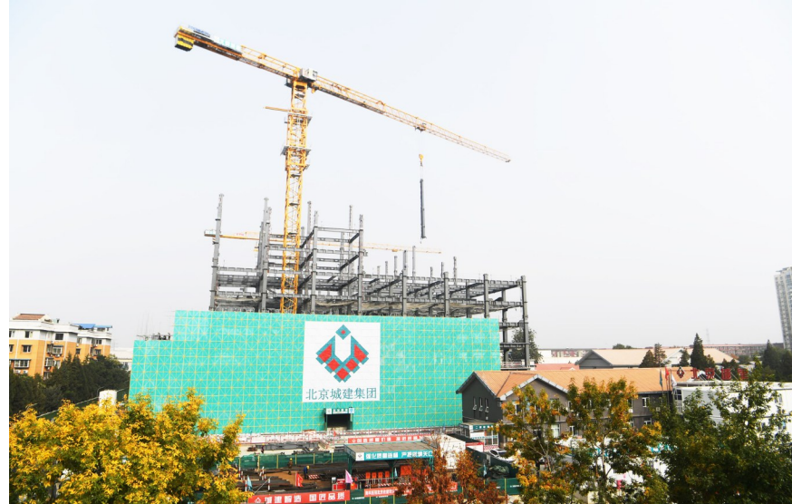
北京胸科医院新建医疗综合楼地上钢结构进度已过半。记者 党维婷/摄
