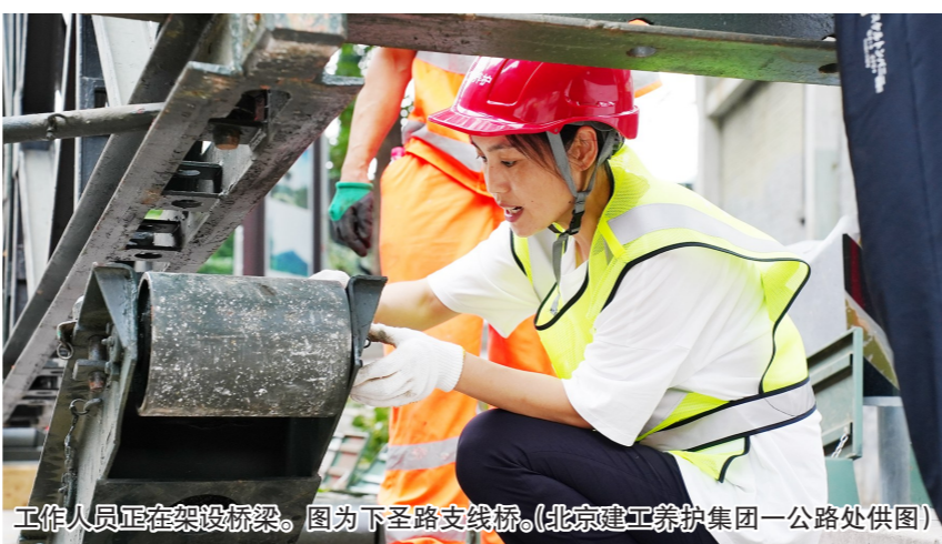
工作人员正在架设钢桥。图为下垫路支线路。(北京建工养护集团一公路处供图)
