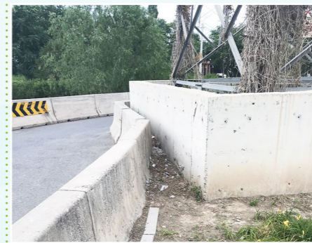
永顺镇潞苑北大街110kv北苑2永之001号电塔下一积存垃圾
