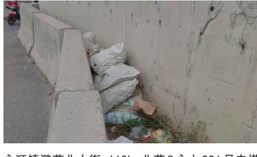
永顺镇潞苑北大街,110kv北苑2永之001号电塔下-积存垃圾
