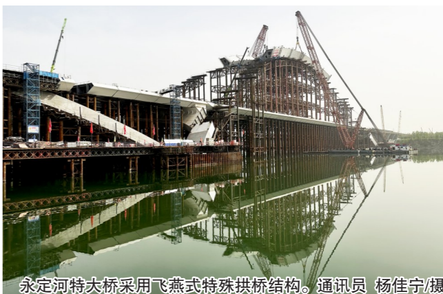
永定河特大桥采用飞燕式特殊拱桥结构。通讯员 杨佳宁/摄
