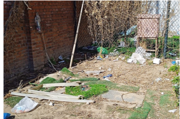
九棵树街道云景西路宏达春林汽车工作室北侧-积存垃圾
