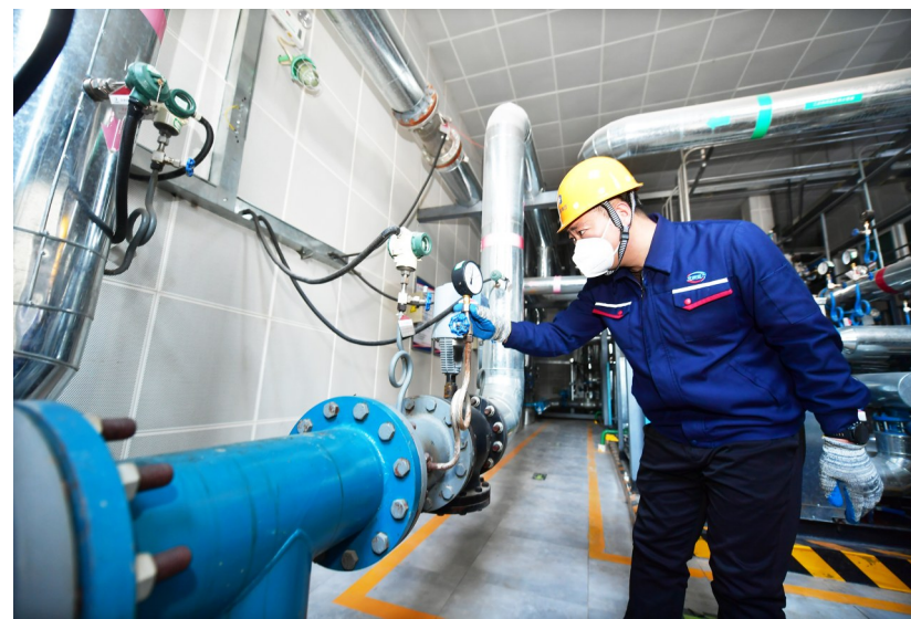
换热站内，工作人员正在检查设备。记者 常鸣摄
