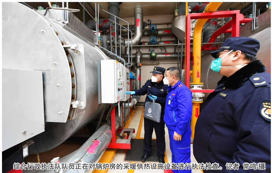
综合行政执法队队员正在对锅炉房的采暖供热设施设备进行执法检查。记者 常鸣/摄
