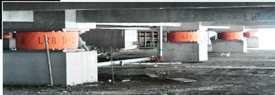
大运河博物馆隔震支座有助于保证建筑主体结构和文物安全。
