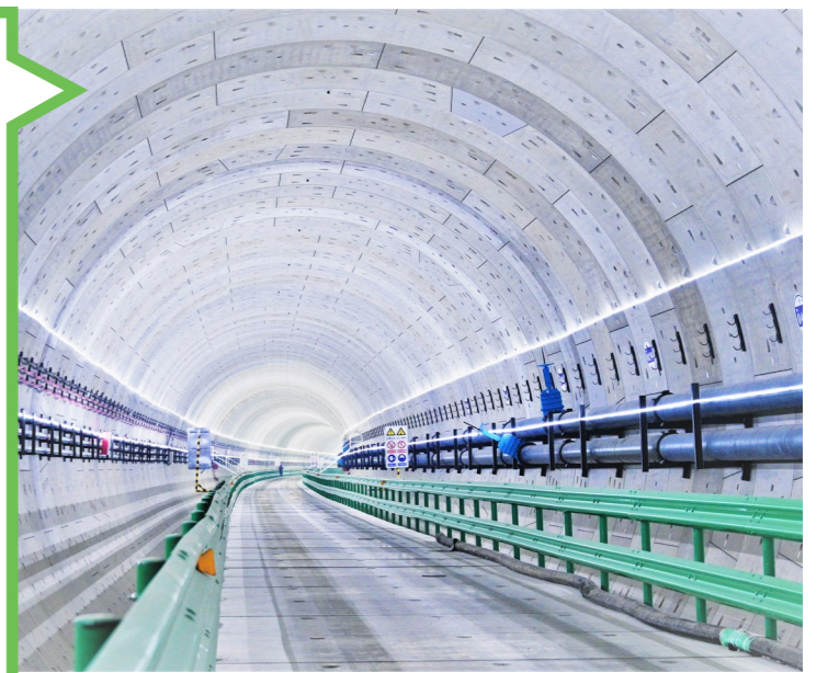
东六环入地工程采用了高效节能的隧道智能通风技术。
