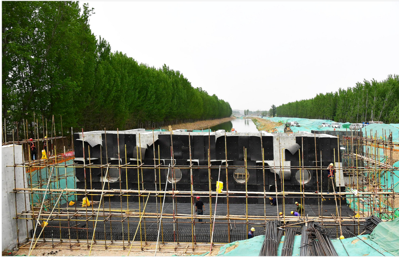
工人正在编织水池底板的钢筋网,为下一步施工做准备。 记者 常鸣/摄
