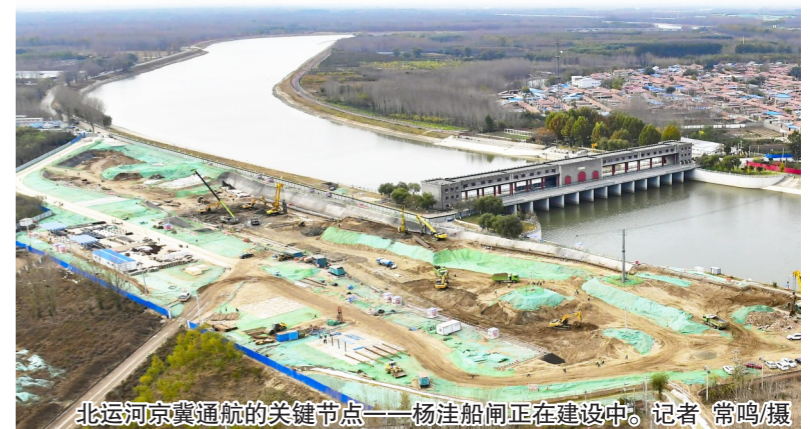
北运河京冀通航的关键节点——杨洼船闸正在建设中。记者 常鸣摄
