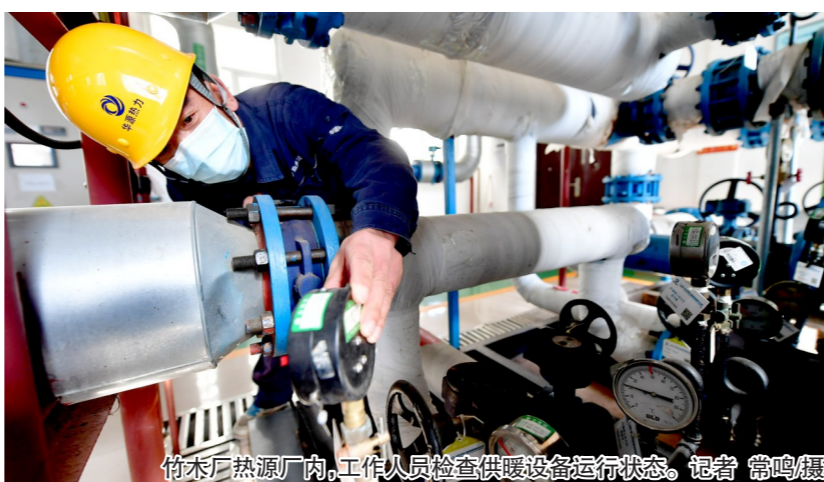
竹木厂热源厂内,工作人员检查供暖设备运行状态。记者 常鸣摄
