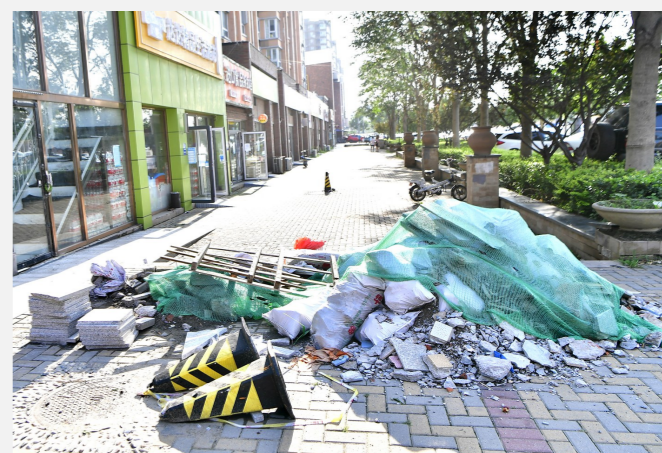
2 昨天,颐瑞东里小区北门,施工垃圾乱堆乱放占据人行便道。
