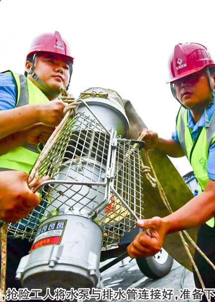
现场,抢险工人将水泵与排水管连接好,准备下放到基坑积水处用于排水。记者 常鸣/摄
