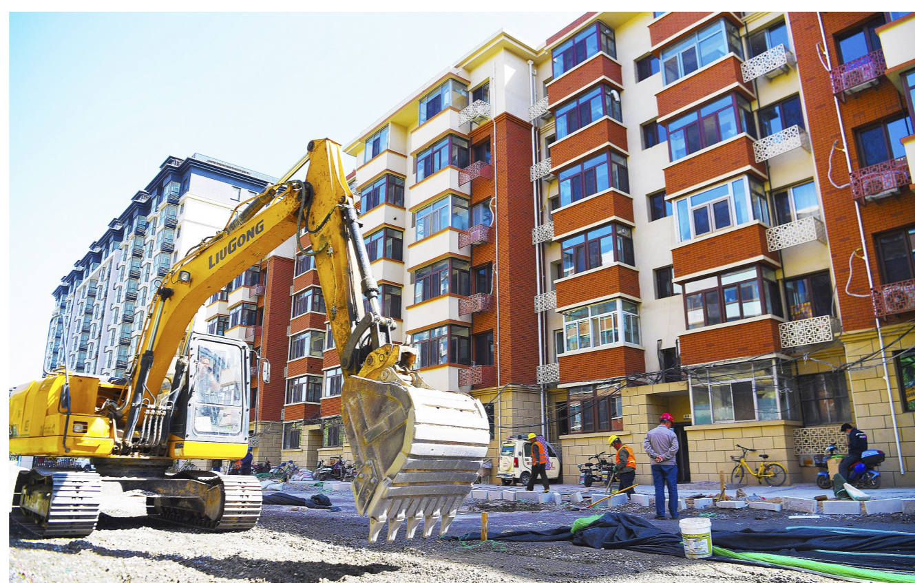
楼房外立面已焕然一新,小区路面硬化施工正在进行中。记者 党维婷/摄
