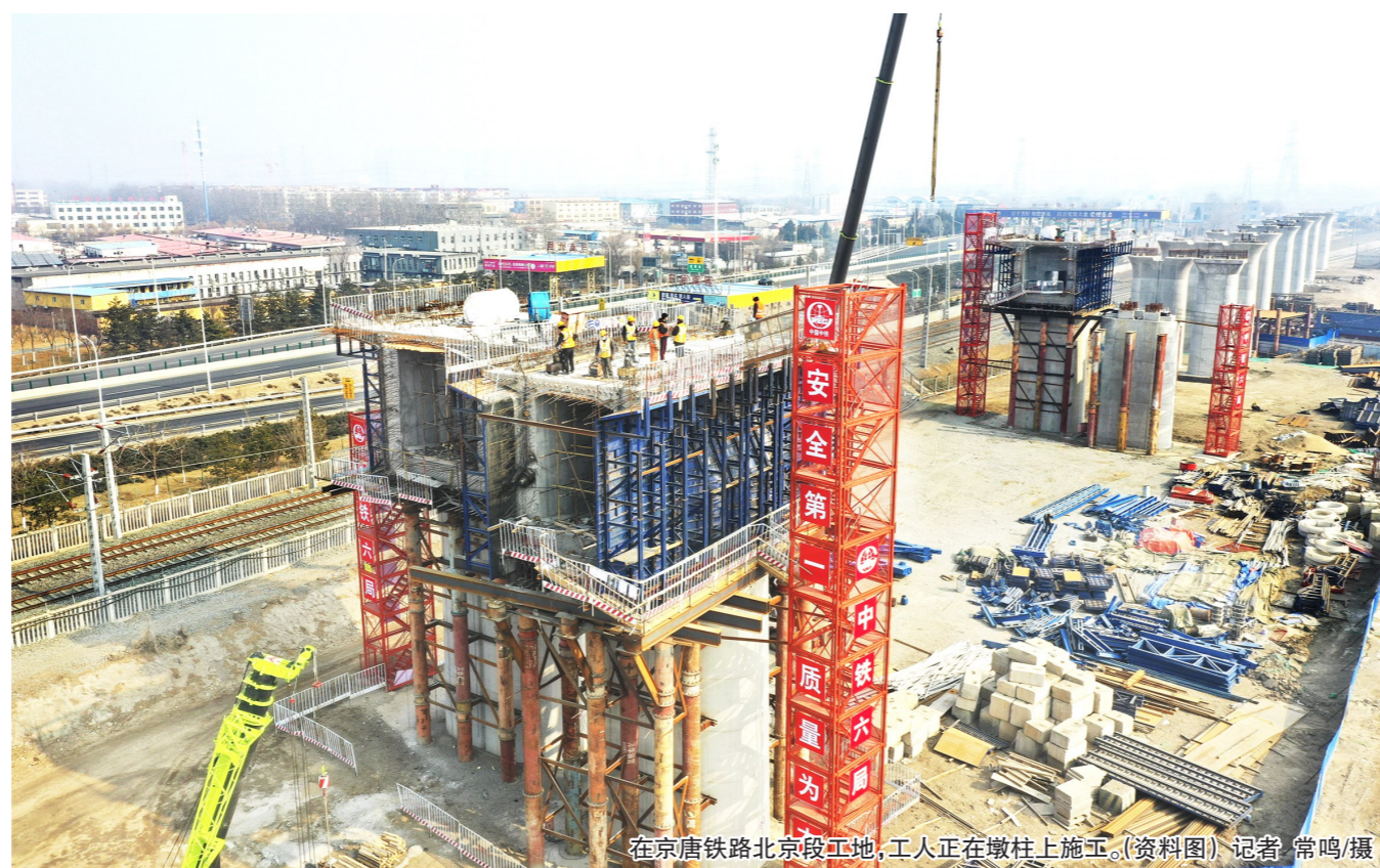
在京唐铁路北京段工地,工人正在墩柱上施工。(资料图)记者 常鸣/摄
