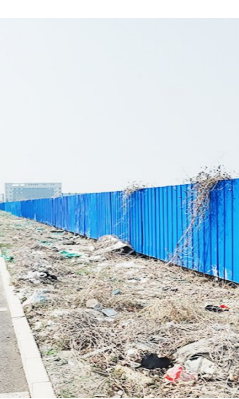
张采路张家湾二桥桥下河渠不洁
