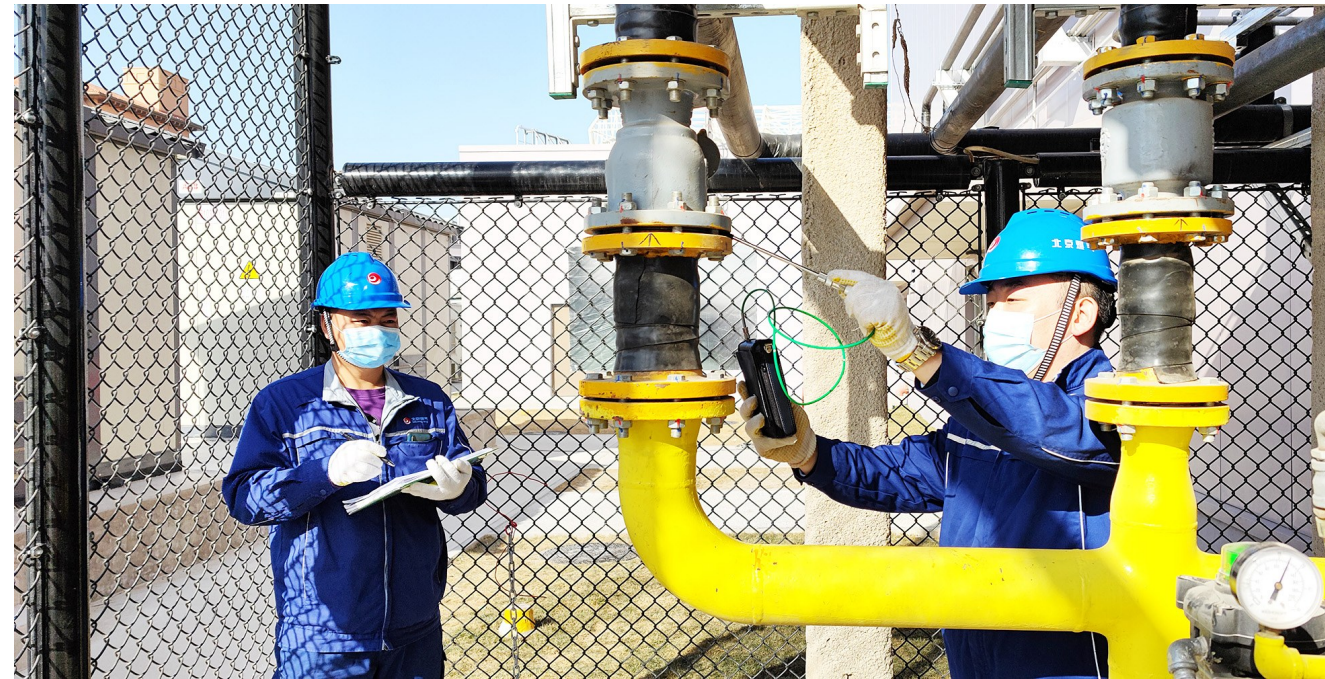
工作人员正在进行设备调试。(北京燃气集团供图)
