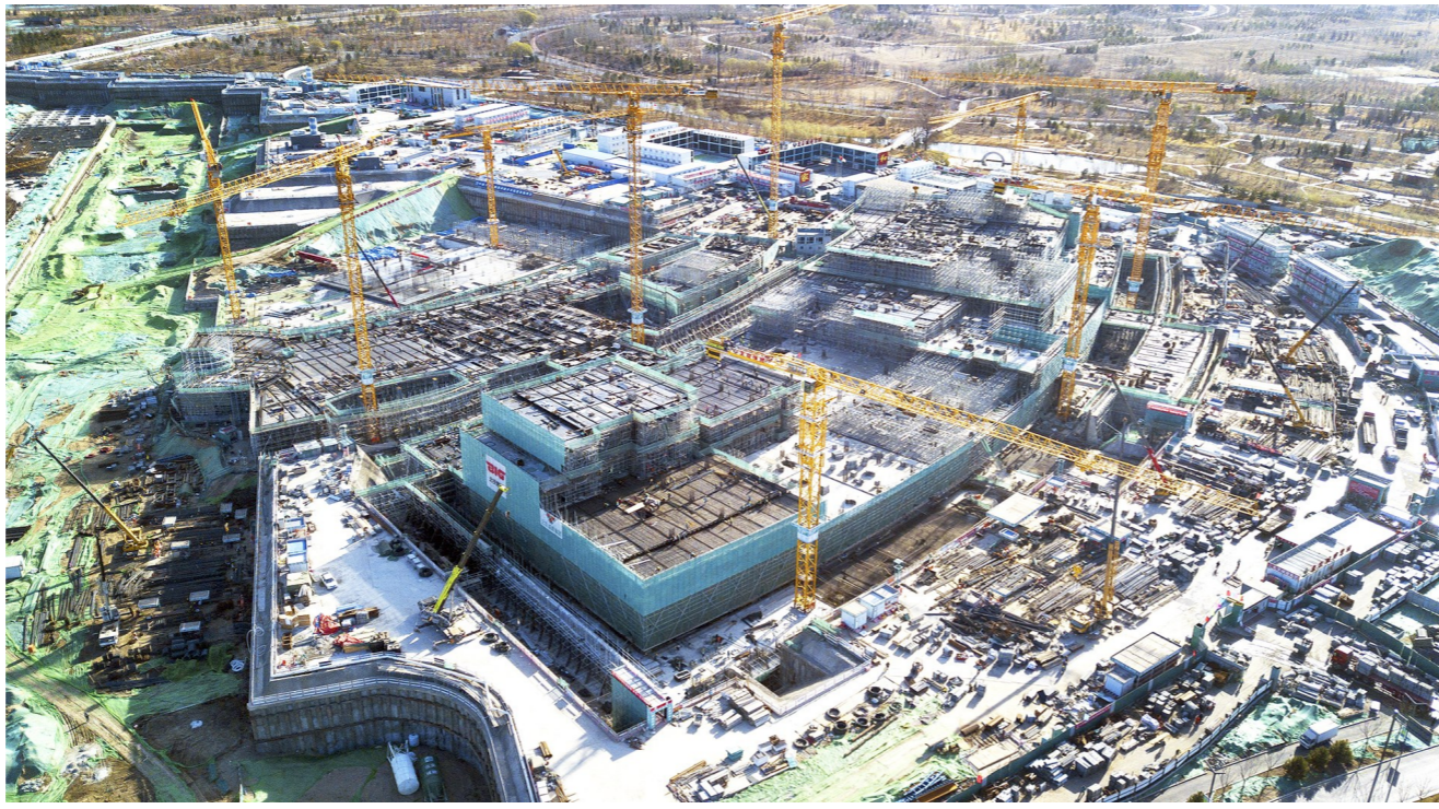
城市副中心博物馆建设现场施工紧张有序进行中。记者 方非/摄
