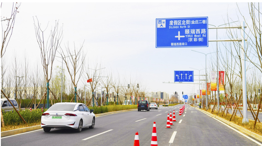
附属设施安装完成,度假区北街正在为环球主题公园开园前的交通压力测试做最后的验收、调试准备。记者 党维婷/摄
