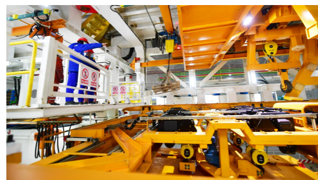
▶“京华号”盾构机内部还有一台轨道起重用来吊运所需物资。
