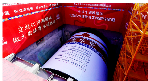
▶在东六环六合桥附近的施工现场，“京华号”盾构机“平躺”在29米深的始发井下。
