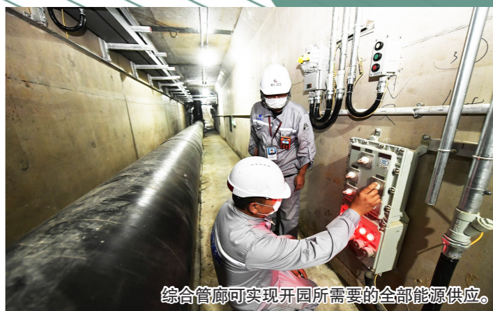
综合管廊可实现开园所需的全部能源供应。
