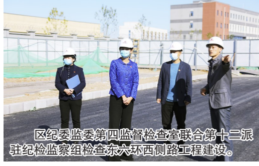
区纪委监委第四监督检查室联合第十二派驻纪检监察组检查东六环西侧路工程建设。
