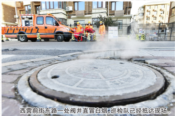
西营前街东路一处阀井直冒白烟,巡检队已经抵达现场。
