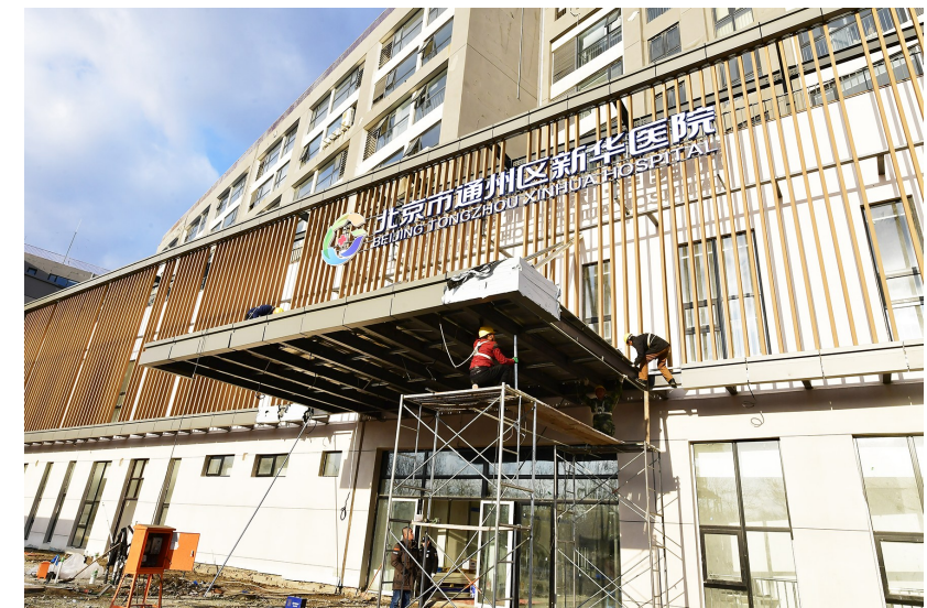
位于九棵树东路386号的新华医院已经挂牌,内部正在安装设备。记者 常鸣/摄
