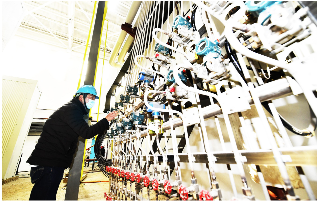
5号调峰热源厂投用,技术人员查看新上岗锅炉设备运行情况。 记者 常鸣/摄
