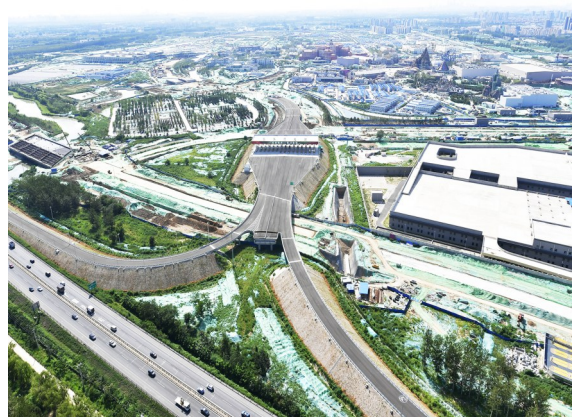
54条市政道路正在加紧建设,方便市民未来出行。记者 常鸣/摄
