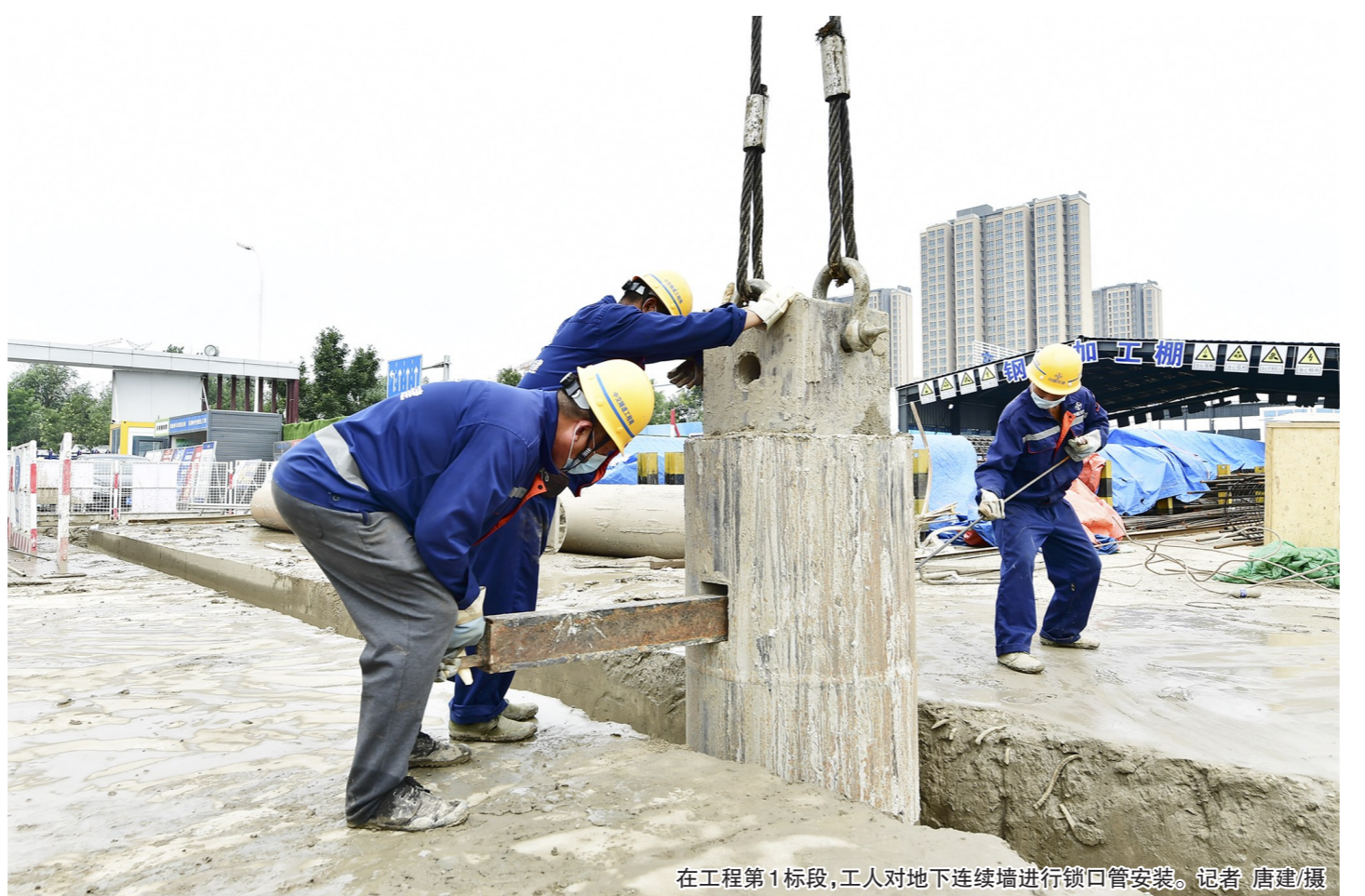
在工程第1标段,工人对地下连续墙进行锁口管安装。记者 唐建/摄
