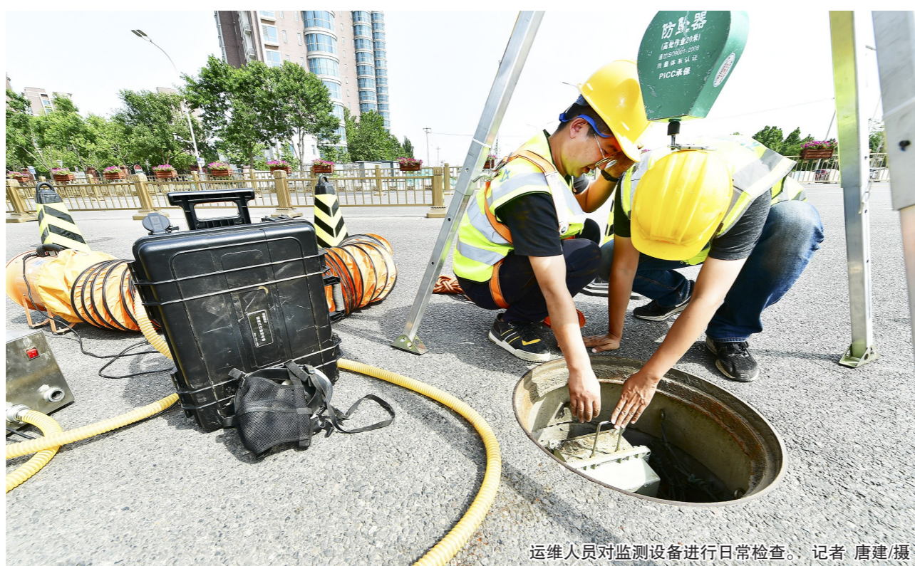
运维人员对监测设备进行日常检查。 记者 唐建/摄
